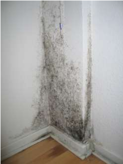
Schimmelbefall auf einer Wand
