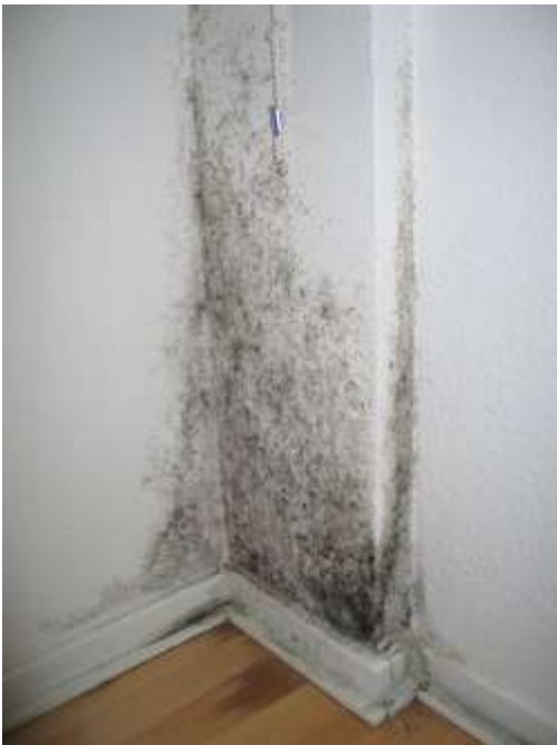
Schimmelbefall auf einer Wand
