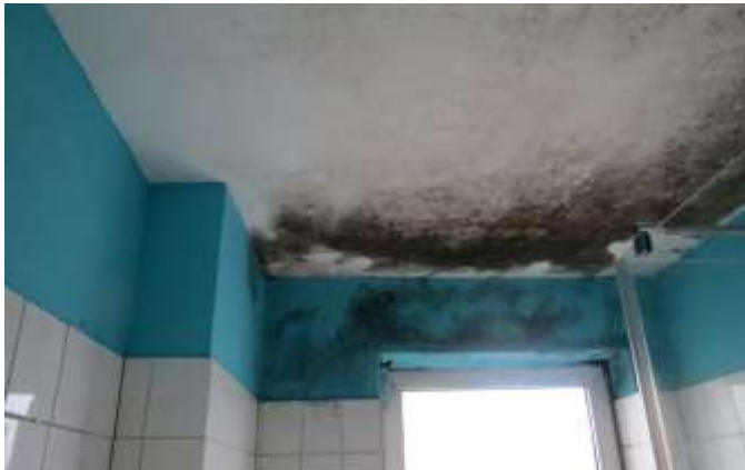
Schimmelpilzbefall in einem Badezimmer
