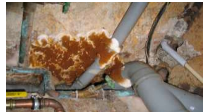
Befall durch echten Hausschwamm
