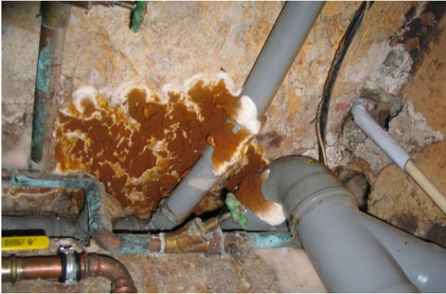
Befall durch echten Hausschwamm
