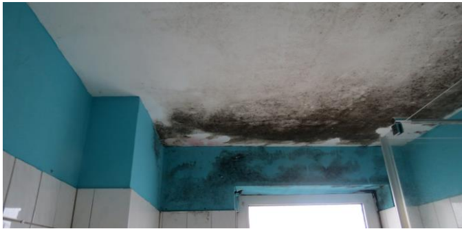
Schimmelpilzbefall in einem Badezimmer
